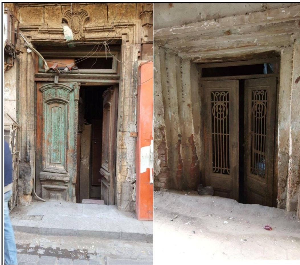
صورة رقم (١) نموذجان لإنخساف عتبات البيوت بقسم الجمالية
