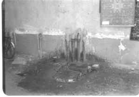
شكل 4: مواسير صرف صحي غير محكمة مما يؤدي إلي تسرب مياه الصرف بين المباني (منطقة حي الأربعين بأسيوط)
