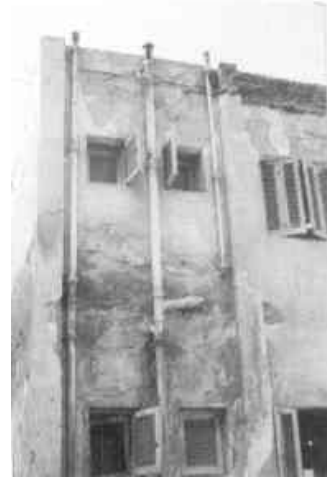
شكل 3: تشوه واجهات المباني وسقوط البياض بعد تشبعها بمياه رشح توصيلات الصرف الصحي السيئة [20].
