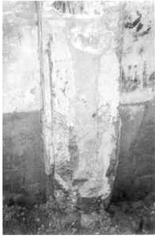
شكل 6: تدهور دعائم المنشأ نتيجة رشح المياه وارتفاع منسوب المياه الجوفية [20].
